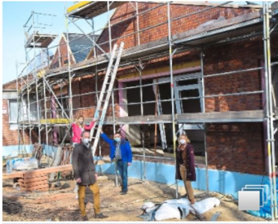
Die markante Form des Neubaus an der Paul-Gerhardt-Schule mit den Giebeln ist bereits gut zu erkennen. Trotz der rund zweiwöchigen Schneepause sind die Bauarbeiten noch immer gut im Zeitplan, sagt Architekt Jörg Krause (vorne) bei einem Baustellen-Rundgang mit Bürgermeisterin Christina Rählmann (v.r.), Hausmeister Georg Büscher und Schulleiterin Carola Brandsmeier.
